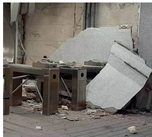
26 Settembre 2020 | Crollo nella stazione metro Salvator Rosa a Napoli a causa delle infiltrazioni d'acqua
