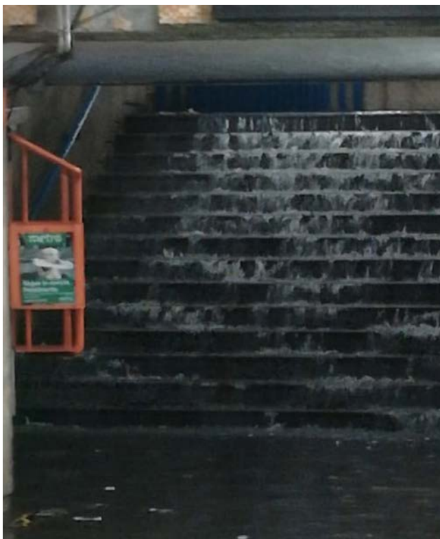
24 gennaio 2021 | Le forti piogge allagano, ancora una volta, la stazione metro Cipro
